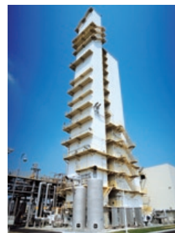
「水- 18 O製造プラント2号機」
