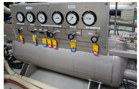
熱交換器ユニット
