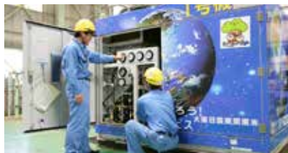
SF 6 回収装置
