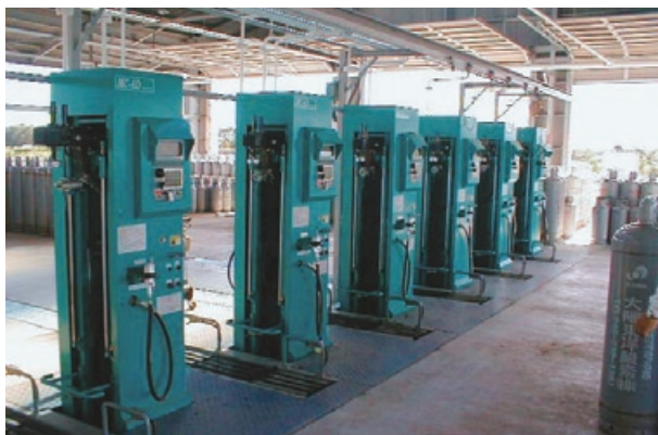
LPガスの充填所
