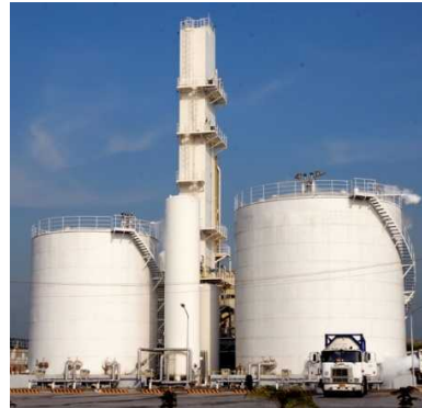
ルソン島パタンガス第2工場 既設プラント
