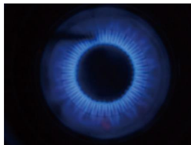
新型小型燃焼式排ガス処理装置 燃焼部
