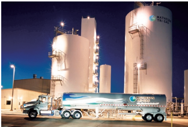
テキサス州アービングの空気分離装置
