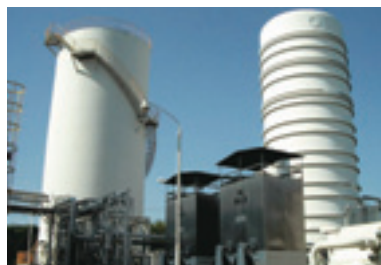
気化供給設備
