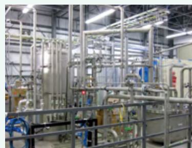
使用されている液体窒素循環冷却システム中枢部
