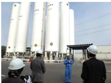
震災後に新しくなった液化ガス貯槽
