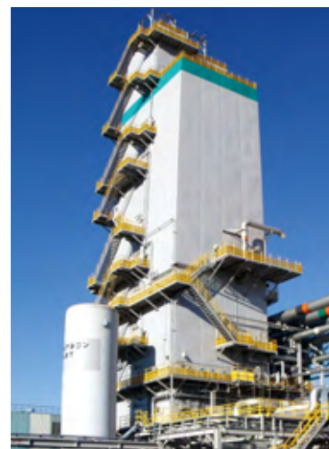
超大型空気分離装置
