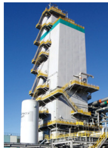
超大型空気分離装置
