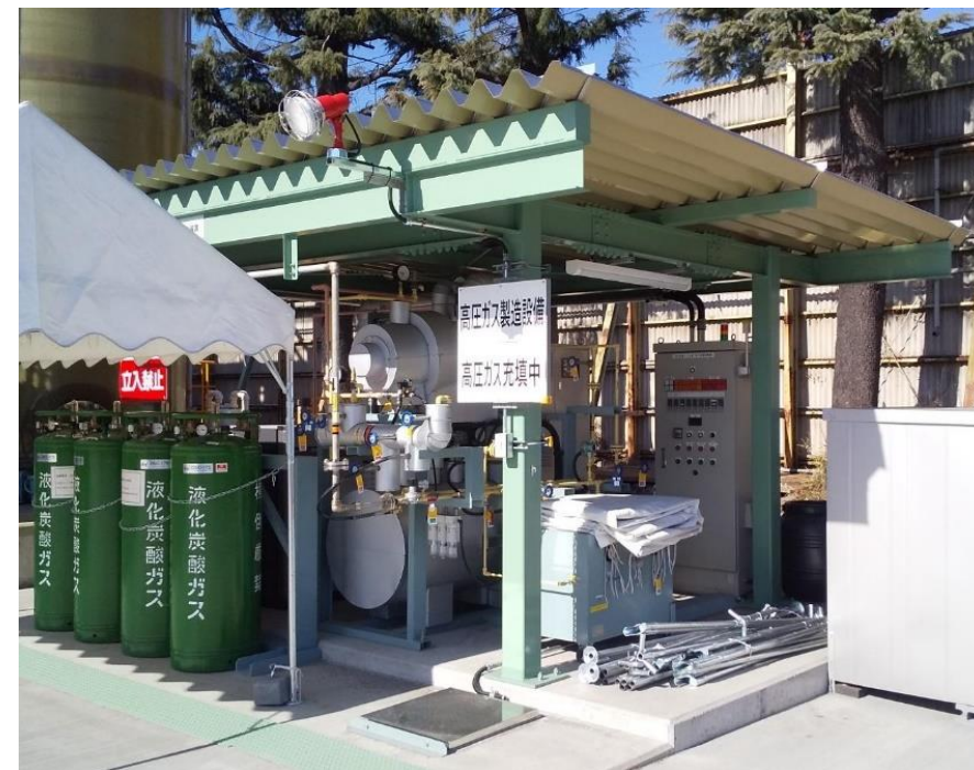
太平洋セメント株式会社熊谷工場 CO 2 液化設備外観
