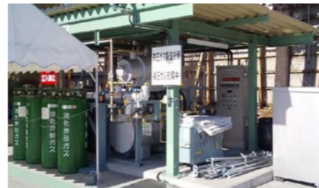
CO 2 液化設備外観
