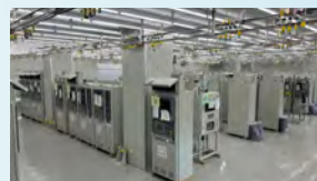
TNET機器製作工場
