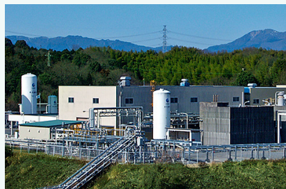
トータルソリューションでお客さまをサポートする「トータル・ガス・センター」
