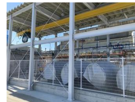
液化アンモニア燃料の貯槽設備
